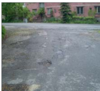
křižovatka ul. Dolní a Šachetní před opravou
