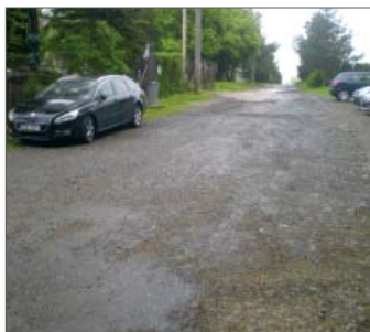
ul. Březinská před opravou
