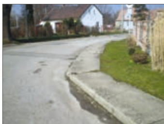
ul. Klimšova před čp. 829 – před opravou
